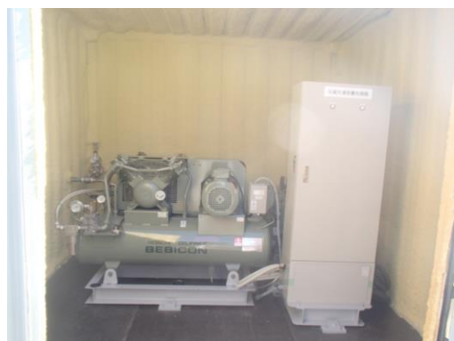
図 4-8 圧縮充填装置の外観（益城町）
