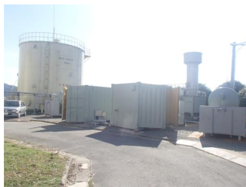
図 4-9 実証プラントの外観（益城町）
