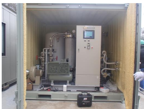
図 4-12 1 塔式 PSA 装置の外観 (大津)
